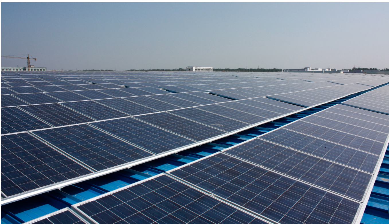
Verdens største tagmonterede anlæg, på 10 megaWatt solcellepaneler fra vores leverandør, til en værdi af 26 mio. dollars.
